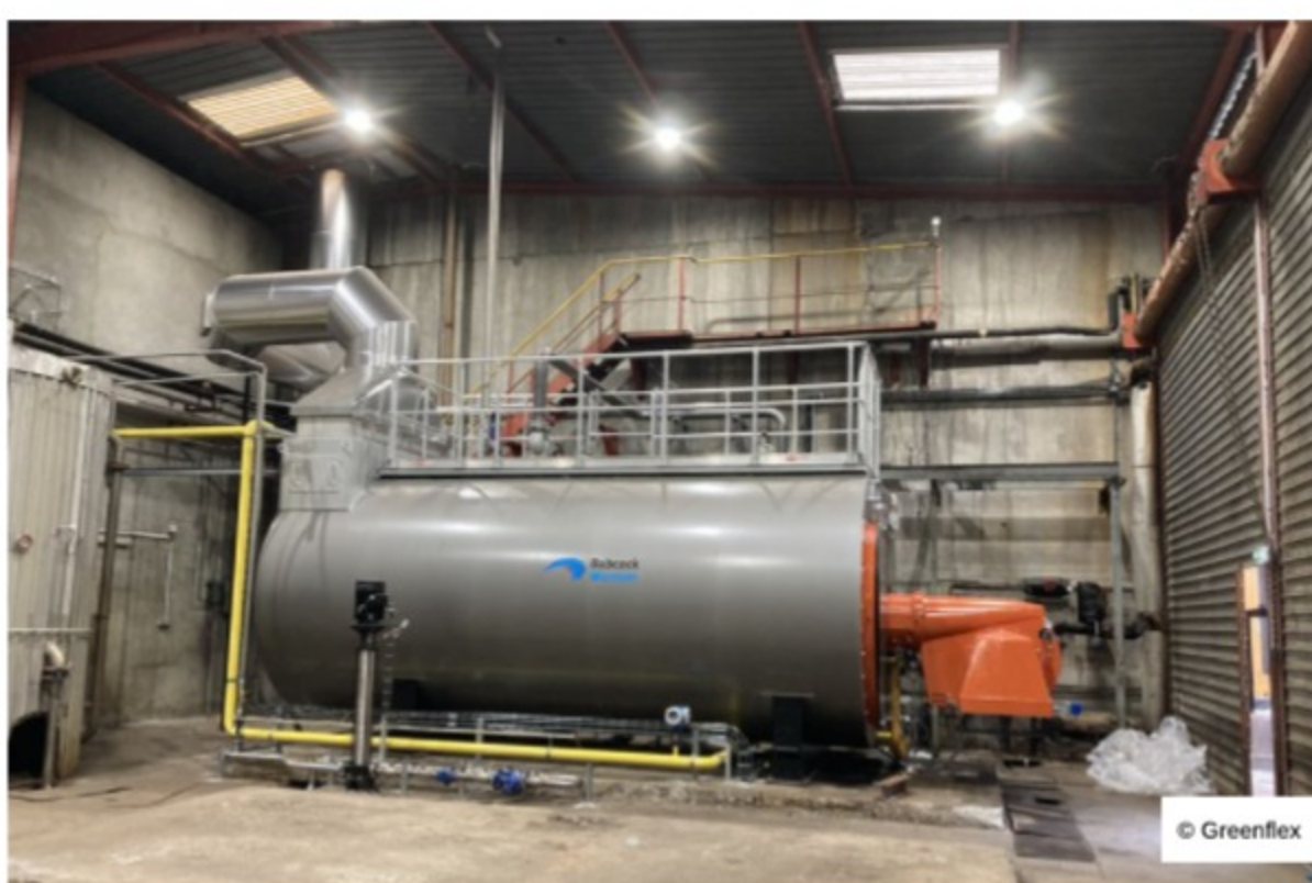
La nouvelle chaudière de la distillerie de la Cavale a été livrée en juin 2021.
